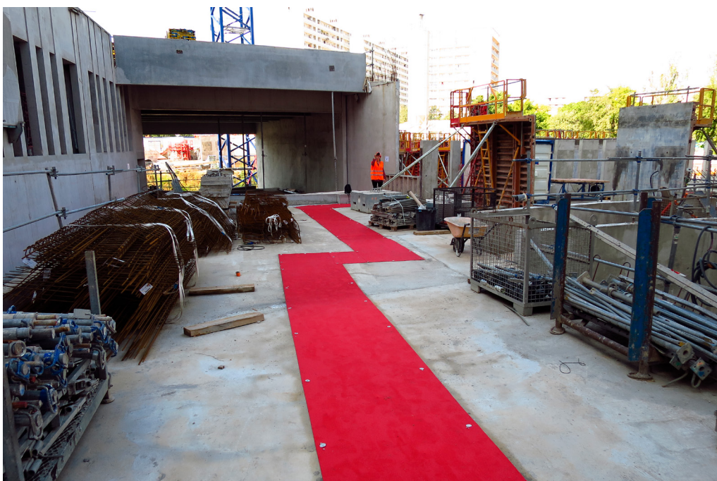
Abb. 5: Sichtbare Kennzeichnung der Flucht- und Rettungswege
