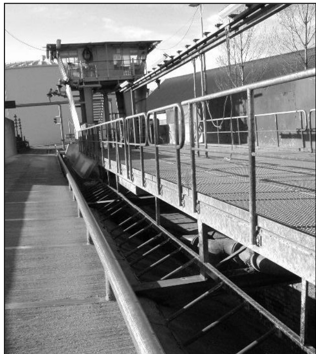
Abbildung 6.4 Plattform mit Geländer an der Rübenentladestation
