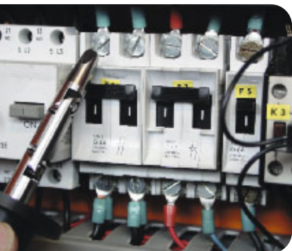
Fehlender Finger- und Handrückschutz an der elektrischen Ausrüstung einer Drehmaschine Baujahr 1985
