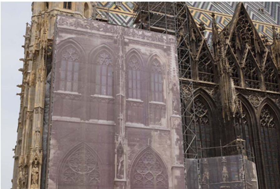
Abb. 6.2 Netz zum Schutz vor Staubbelastungen mit repräsentativer Abbildung mit gleichzeitig abschattender Wirkung an Gerüstarbeitsplätzen
