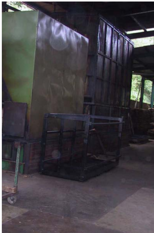
Abb. 6.7 Anlage zur Heiß-Kalt-Tränkung
