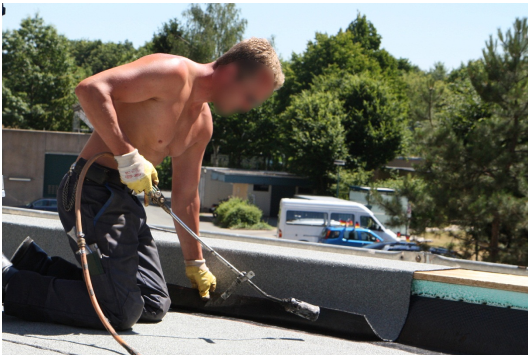
Abb. 6.6 Unsachgemäße Kleidung auf einer Baustelle
