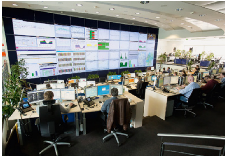
Abb. 8 Großbildtechnik in einer Leitwarte
